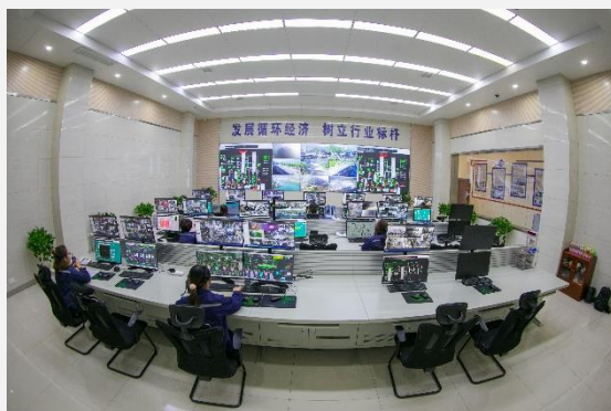
▲ 整改后的刘草坡集控室
